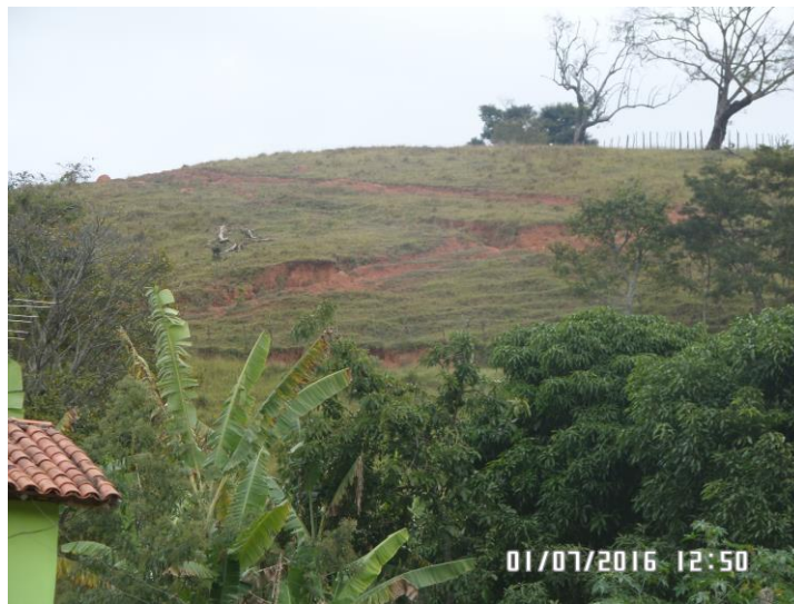
Figura 6.5 – Processo erosivo em área de encosta na comunidade de Maciel
